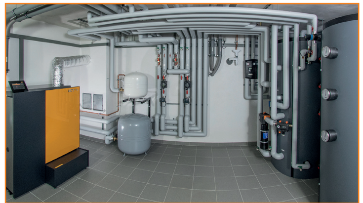
Pelletheizungs-Anlage eines unserer Kunden Beratung, Verkauf, Einbau und Inbetriebnahme erfolgte nur durch uns.
